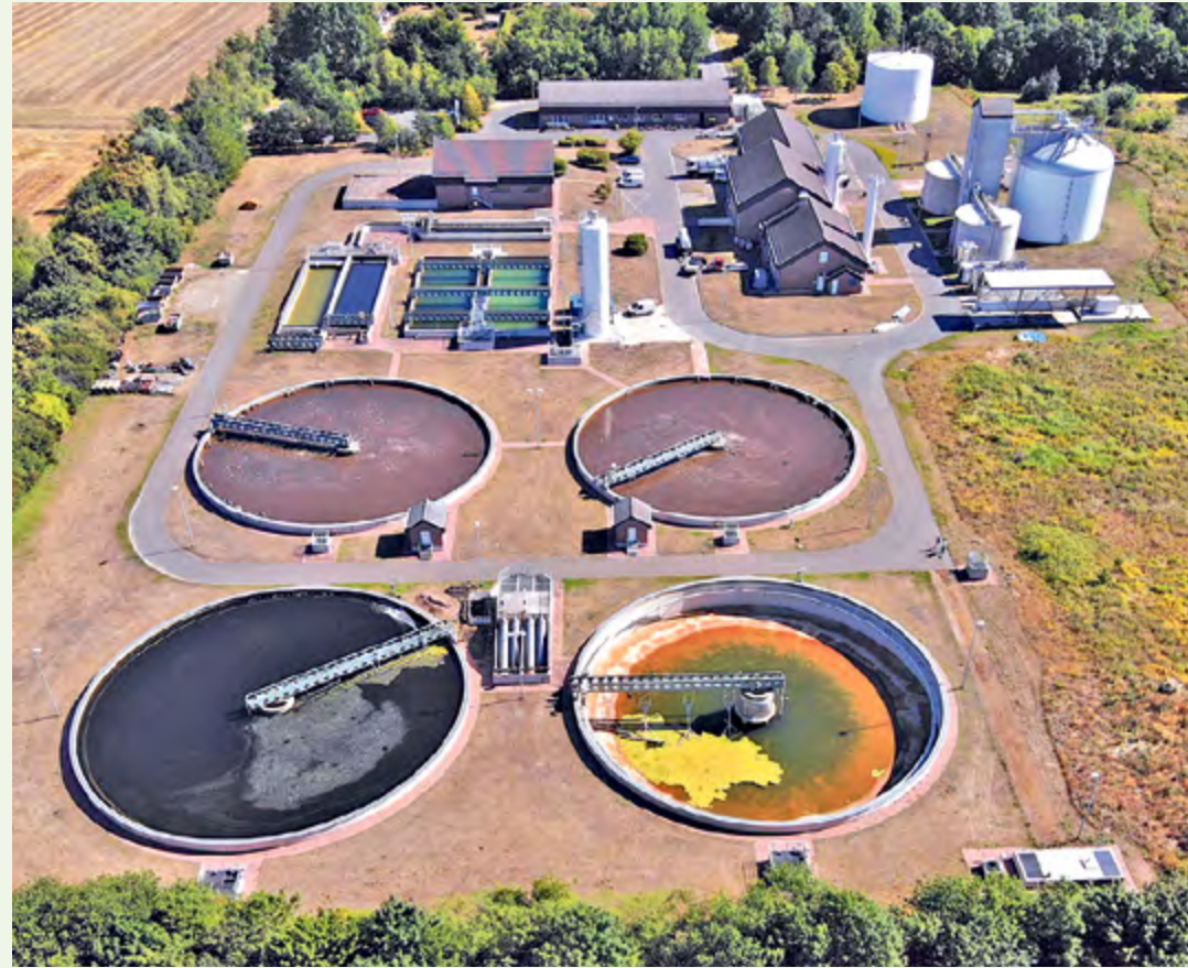
Auf seiner Kläranlage in Brieske bündelt der Wasserverband Lausitz (WAL) verpflichtende Investitionen, die sich auch für ihn aus der Kommunalabwasserrichtlinie (KARL) ergeben.
