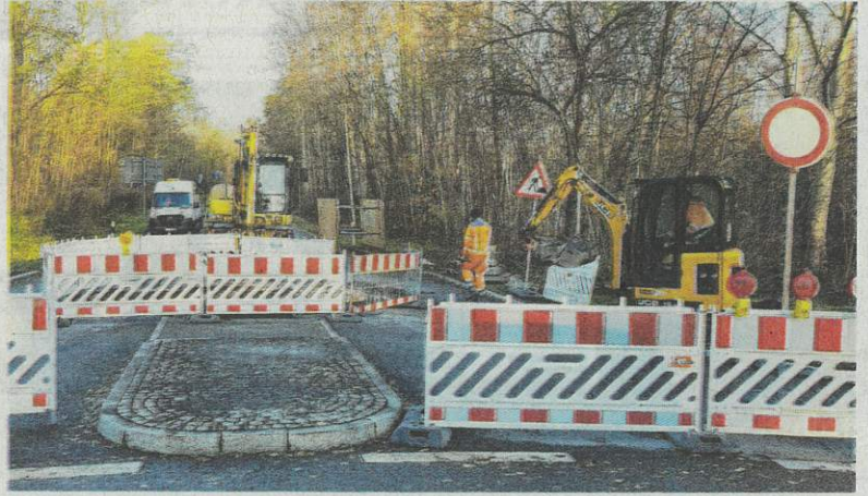
Ein Wasserrohrbruch zwingt Autofahrer in Lauchhammer zu einer Umleitung.
