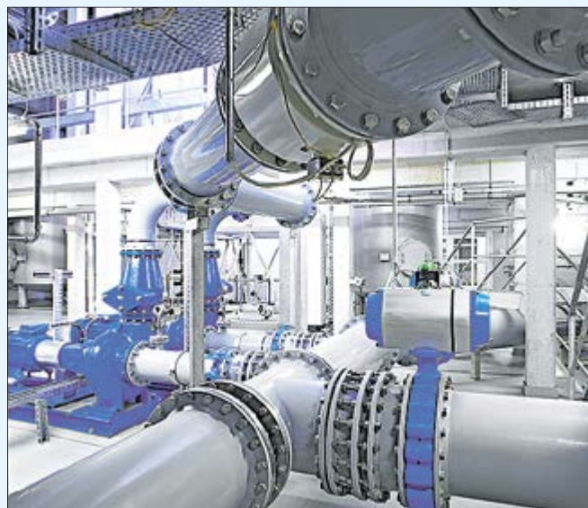
Wege reinsten Wassers im Wasserwerk Tettau.
