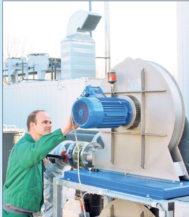
Marko Löppitz, Anlagenmechaniker und Klärwerker bei WAL-Betrieb, ist gründlich vertraut mit der anspruchsvollen Technik der Co-Vergärung. Der Container dahinter birgt eines der neuen BHKW.
