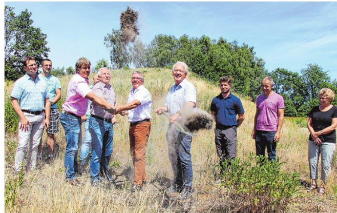
Der Spatenstich für die Erschließung des Wohngebietes »Am Großteich« in Lindenau ist erfolgt. Hier schwingen die beiden Spaten Kersten Sickert (3.v.l.), Amtdirektor des Amtes Ortrand, Jürgen Bruntsch (4.v.l.), langjähriger Bürgermeister in Lindenau, Ralf Herrmann (5.v.l.), aktueller Bürgermeister in Lindenau sowie Dr. Roland Socher (4.v.r.), Verbandsvorsteher des Wasserverbandes Lausitz (WAL). Foto: sts
