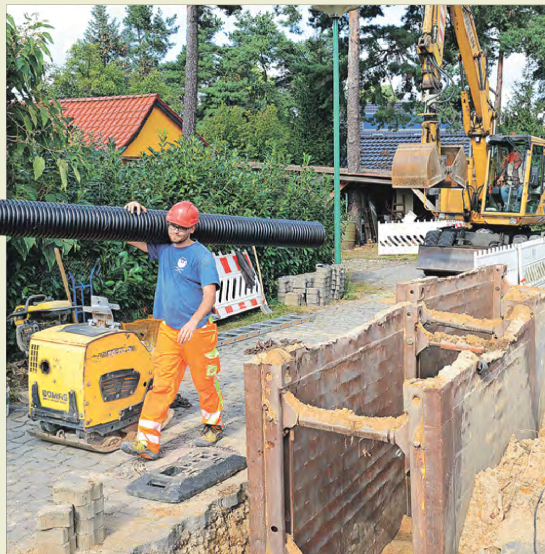
Bald heißt es für die Waldweg-Anwohner in Großkoschen „Sammelgrube ade!“ Die bei der Schmutzwasserschließung eingesetzten Rohre kommen übrigens fast aus der Nachbarschaft, nämlich von den Fränkischen Rohrwerken Schwarzheide.
