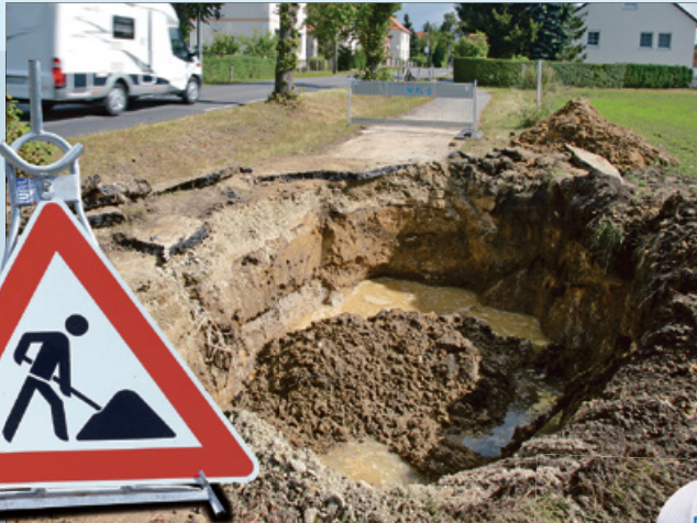
Zwar vergehen zwischen Absperrung der Havariestelle und der Reparatur samt Verfüllung und Wiederherstellung der Oberflächen nur wenige Stunden, doch ist jeder Rohrbruch einer zu viel.
