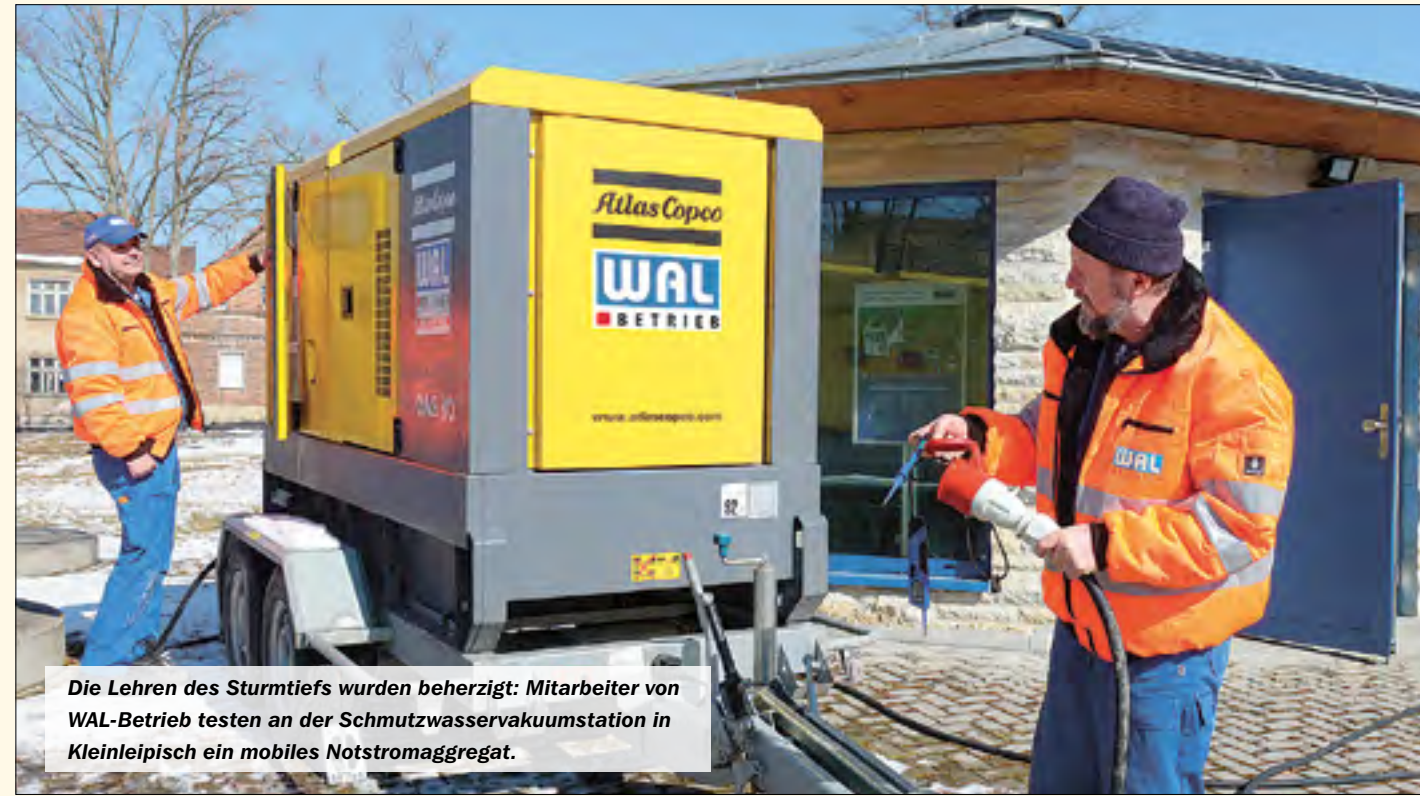
Die Lehren des Sturmtiefs wurden beherzigt: Mitarbeiter von WAL-Betrieb testen an der Schmutzwasservakuumsstation in Kleinleipisch ein mobiles Notstromaggregat.
