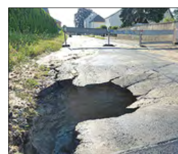
Die Erde hat sich aufgetan – mit dem Loch in der Eisenbahnstraße verriet sich der Rohrbruch.
