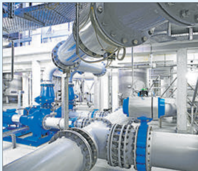
Wege reinsten Wassers im Wasserwerk Tettau.
