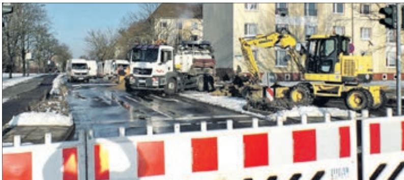
Mit schnellem und massivem Technikeinsatz reagierte WAL-Betrieb auf den Rohrbruch; dennoch war eine Absperrung in der Wilhelm-Pieck-Straße unumgänglich. Foto: WAL-Betrieb
