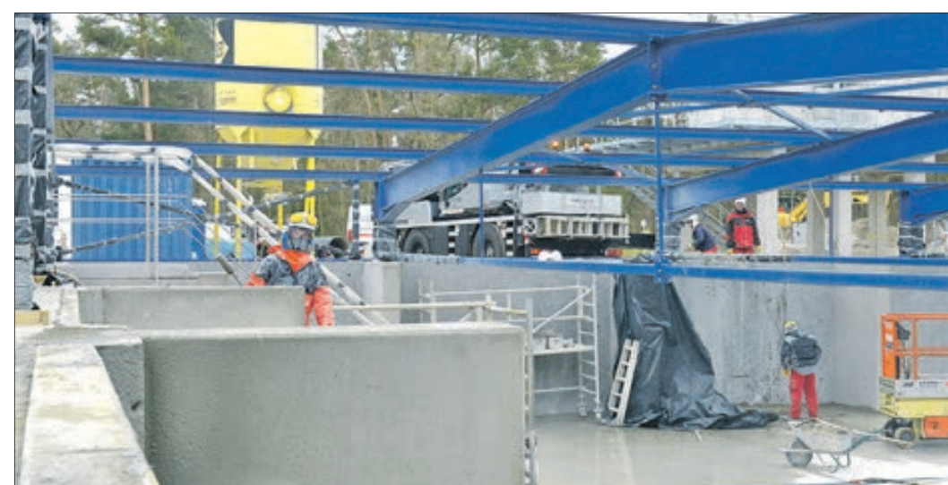
Endspurt auch bei der Sanierung des alten Reinwasserspeichers. Im Mai geht der Erweiterungsbau in Betrieb.
