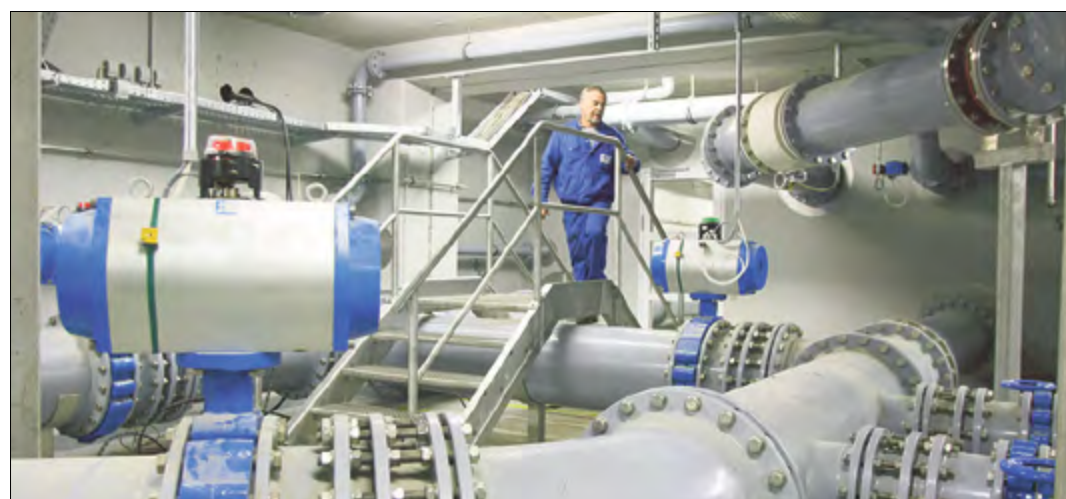
Immer unter Kontrolle – im Wasserwerk Tettau sorgen moderne Technik und erfahrene Fachleute für die verlässlich hohe Qualität des Trinkwassers. Foto: SPREE-PR/Rasche
