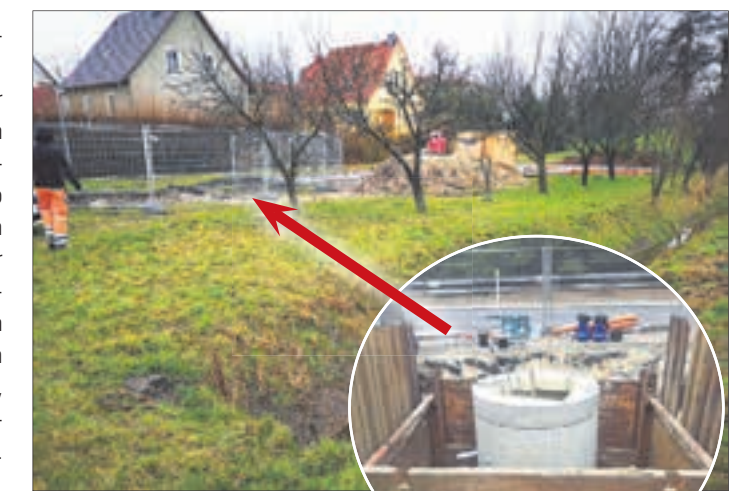
Hinter der Einzäunung in Schacksdorf muss nach nur 25 Betriebsjahren der Pumpenschacht komplett erneuert werden.
