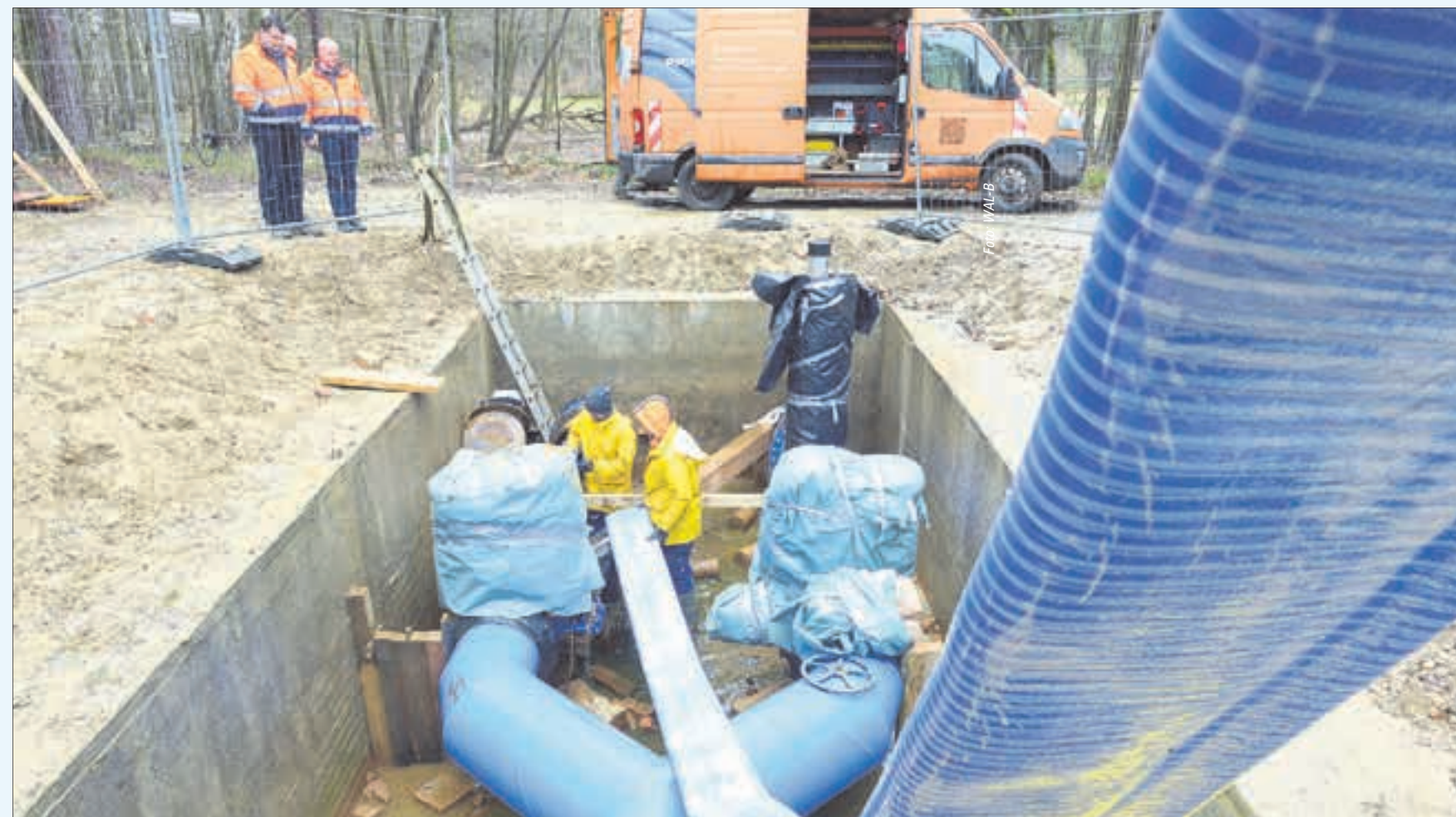
In die alten Stahlleitungen unter dem Schwarzwasser zwischen Jannowitz und Lipsa werden zur Sanierung neuartige Inliner eingezogen.
