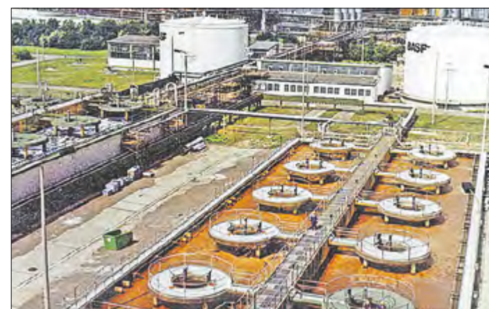
Die BASF-Kläranlage bot sich schon Anfang der 1990er zur Mitnutzung an.
