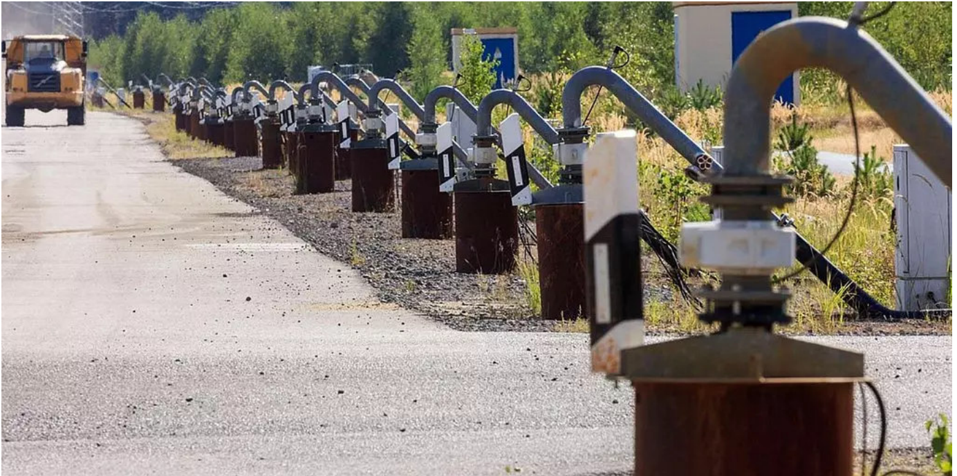
Entwässerungspumpen im Zuge des Tagebaus der Leag
